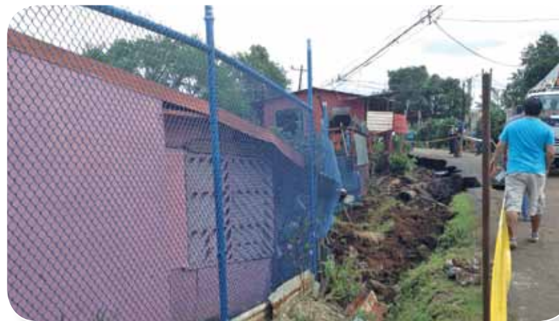
Imagen de los daños en Sarchí. CNE.
