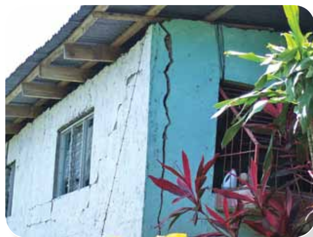
Daños en las viviendas. Cruz Roja Costarricense.
