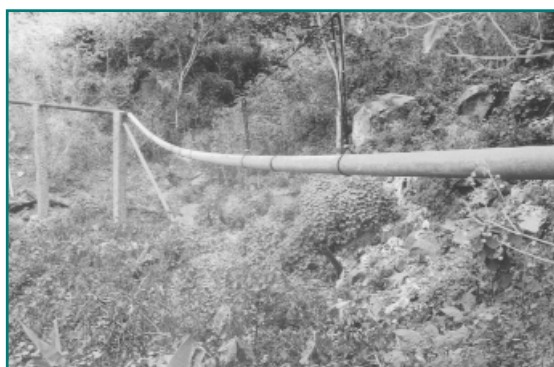
Rehabilitación de cruce de quebrada dañado por deslizamiento producido por terremoto, el cual fue afectado nuevamente por deslizamiento producto de lluvias intensas sólo un par de meses más tarde.
